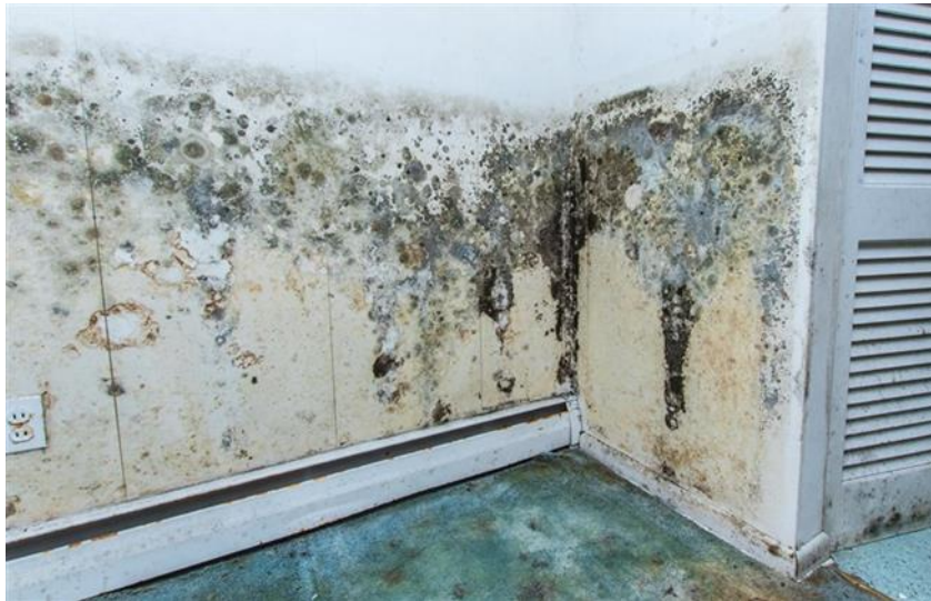
Gambarajah 1.0 : Dinding bangunan dengan serangan kulat
